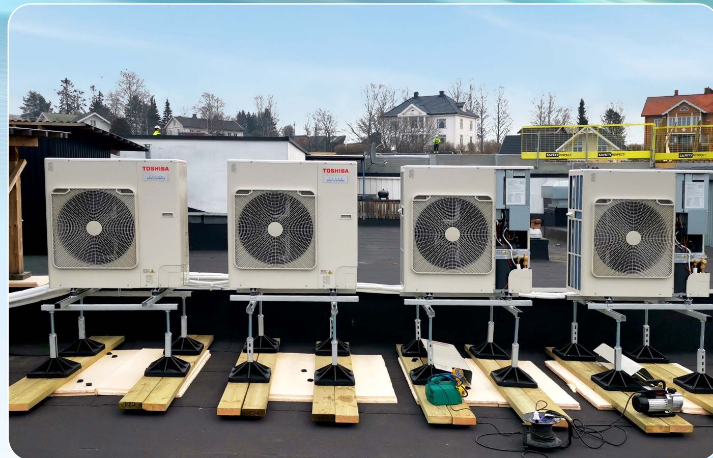
Under montasjen. Prosjektering og montasje ble utført av Nek AS, Årnes.
